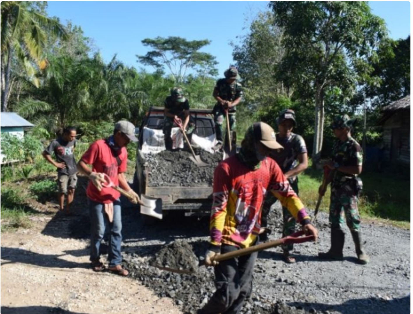
Anggota Satgas TMMMD ke-113 Kodim 1005/Barito Kuala Bersama Warga Lakukan Pengurukan Jalan
